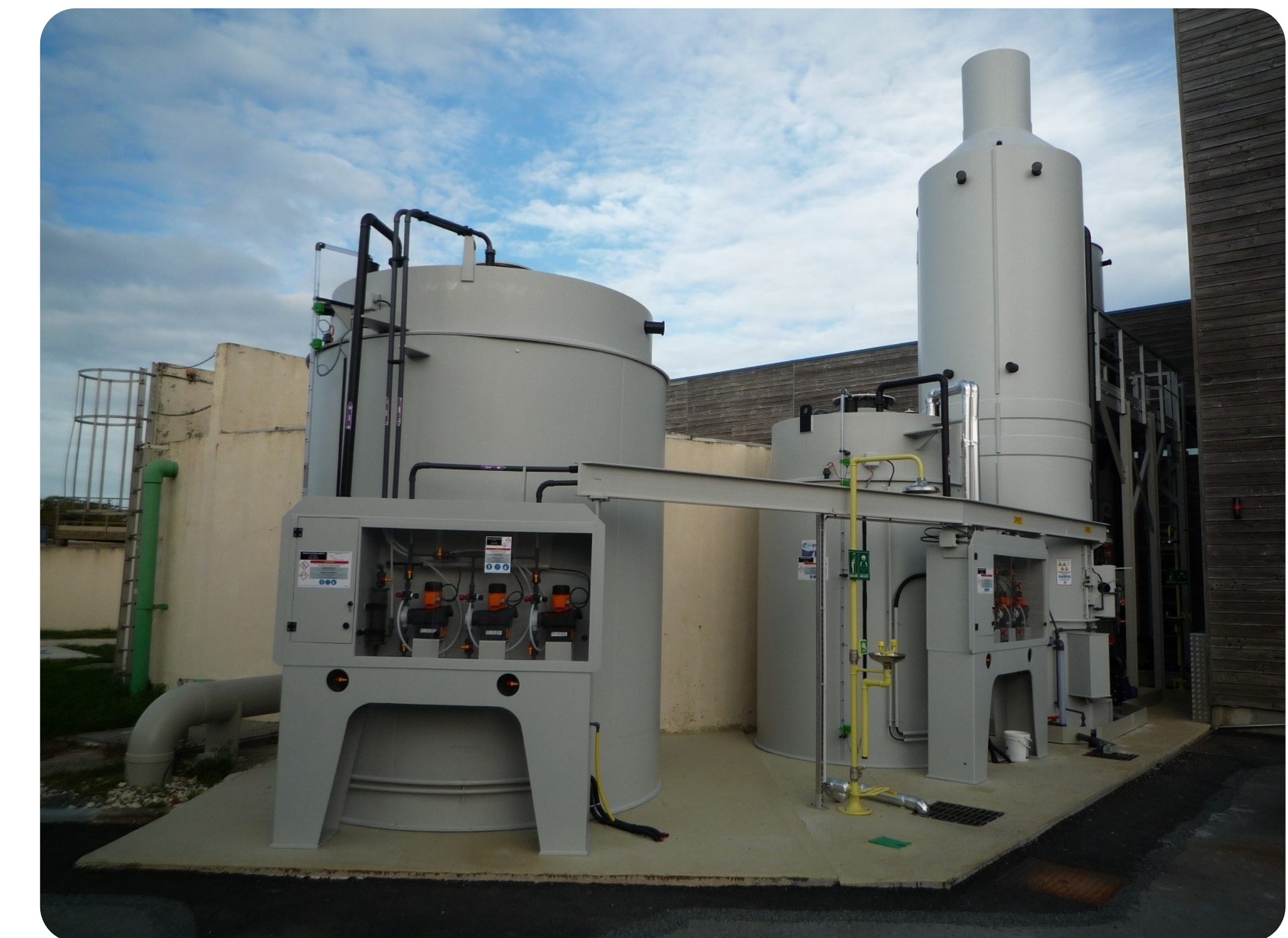
Installation de lavage de gaz
