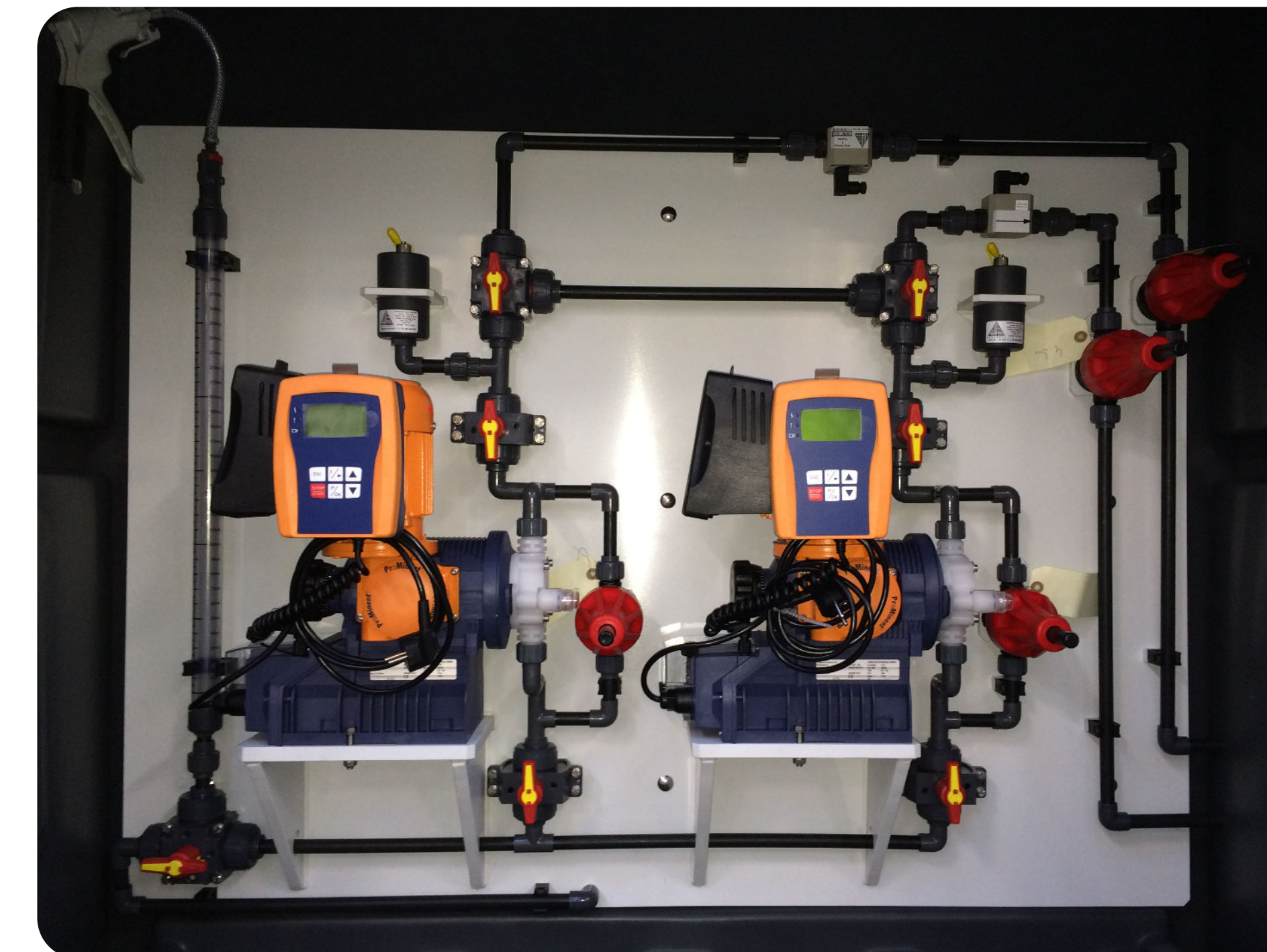
Tuyauterie de dosage
